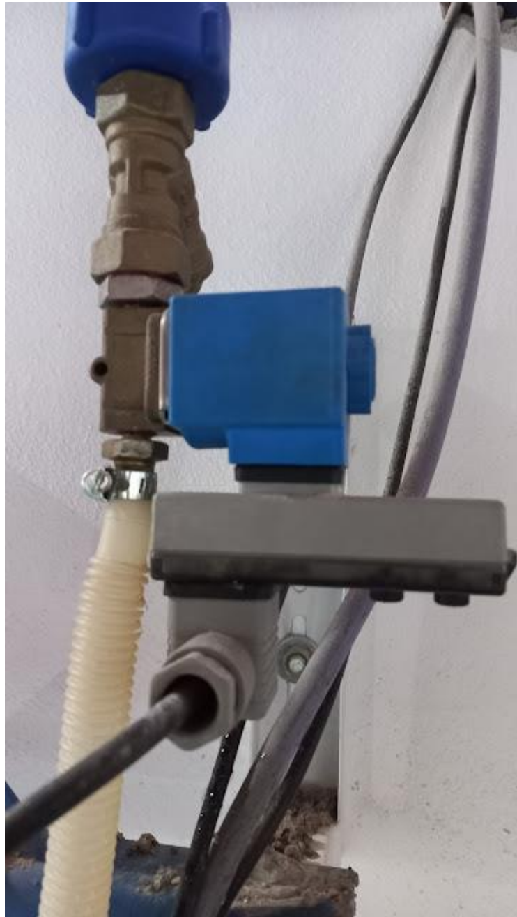
Purgador automático de posenfriador.
