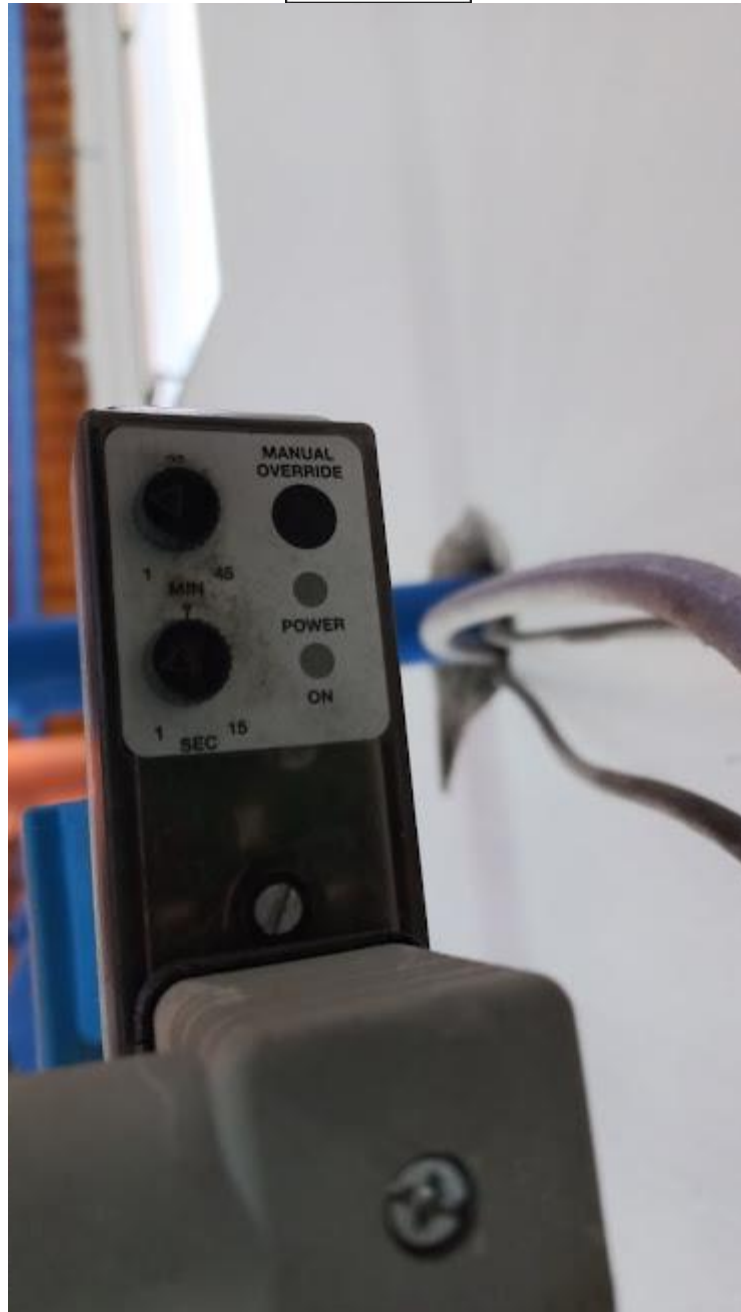
Control de purgador automático.
