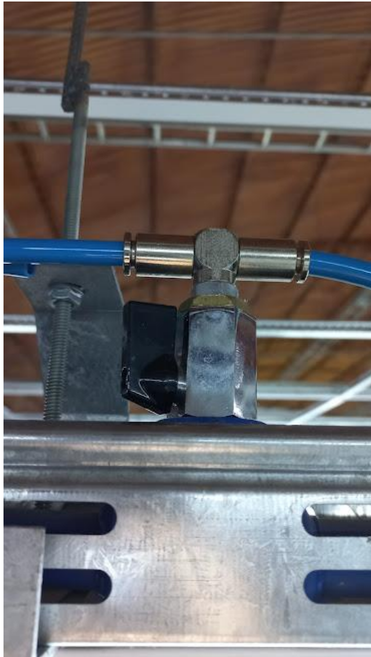
Sistema llavín, acople reductor y Tee, con conexiones a máquinas en funcionamiento.
