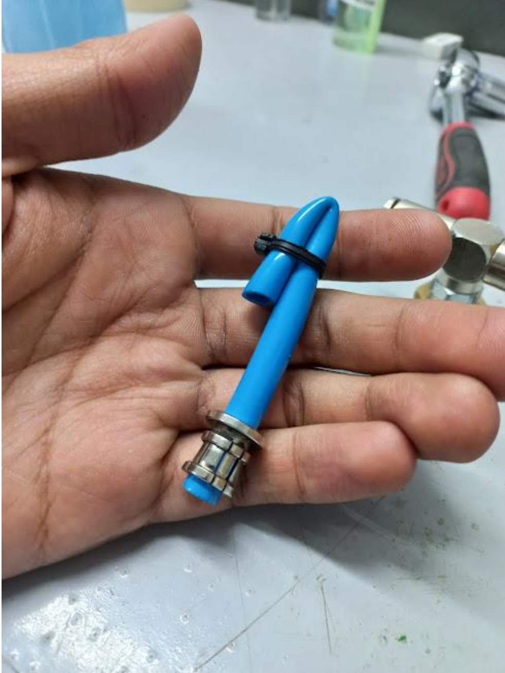
Falla en el acople de salida de Tee, conectada a tapón.
