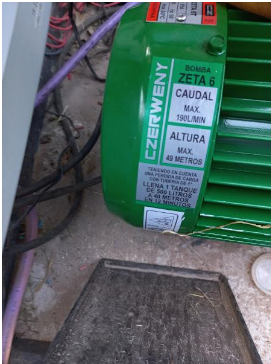
Otras especificaciones de la bomba.
