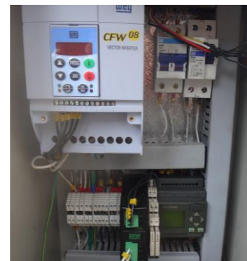
Figura 5. Tablero de PLC y reguladores
