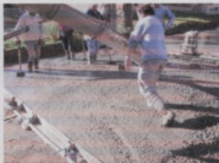
Final del tramo recto - Junta de expansión
