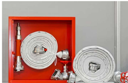
Figura 164| Bocas de incendio con mangueras para interiores. Fuente: https://prevencionar.com/2015/08/25/prevenconsejo-utilizacion-de-bocas-de-incendio-equipadas-bie/
