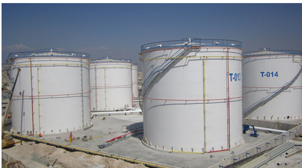
Figura N°49: Tanque de almacenamiento para Bioetanol
