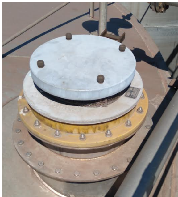
Figura N°3: Válvula de seguridad de tanque almacenamiento
