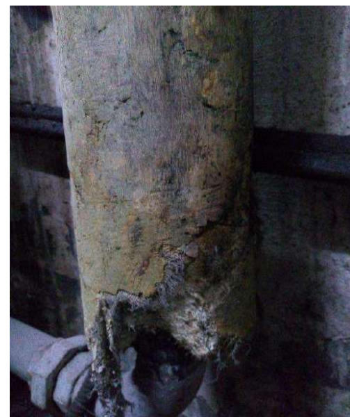
Bajada de cañería con material aislante.
