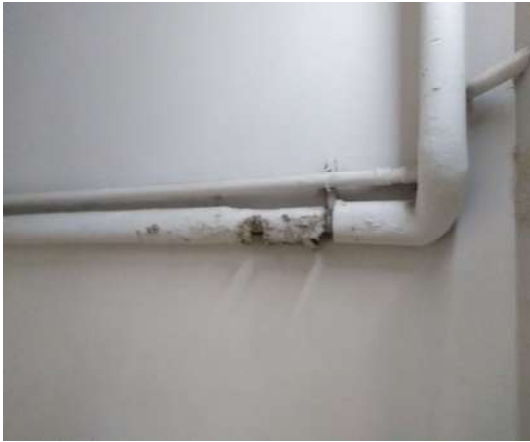
Detalle material aislante averiado.
