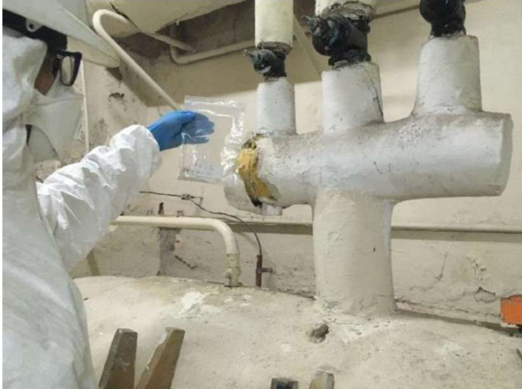
Muestra 1: se obtiene desde zona averiada de material aislante de la cañería.
