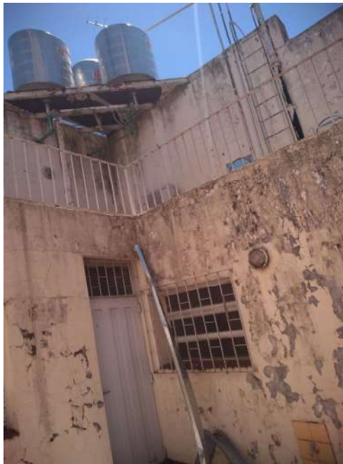
Detalle de residuos por cambio de tecnología de material de tanque para agua acero asbesto por acero inoxidable.
