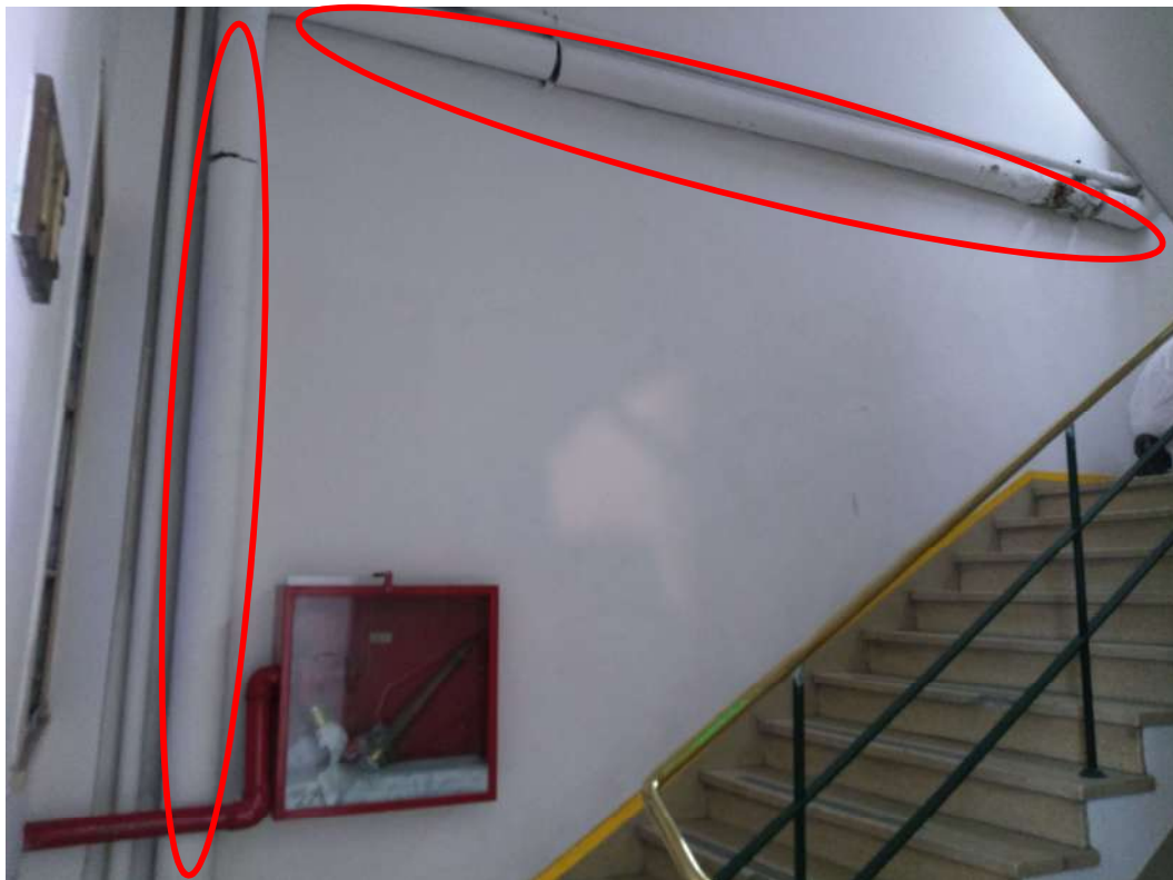
Detalle cañería con material aislante.
