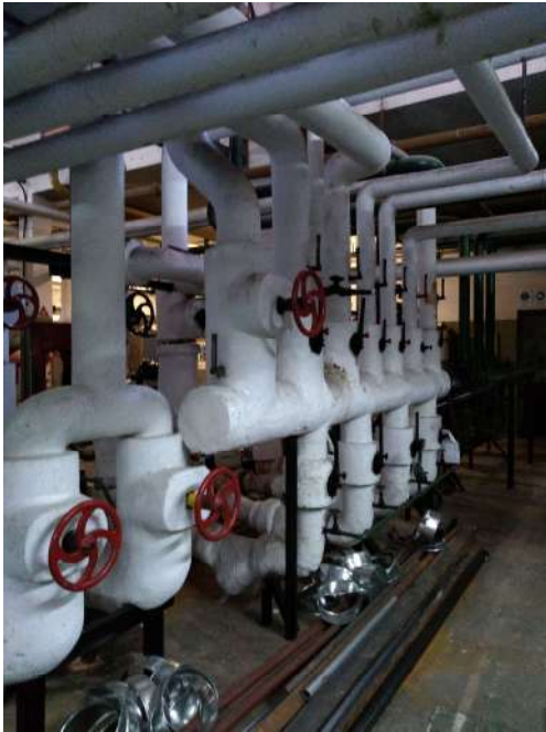
Detalle general de cañerías de la caldera.
