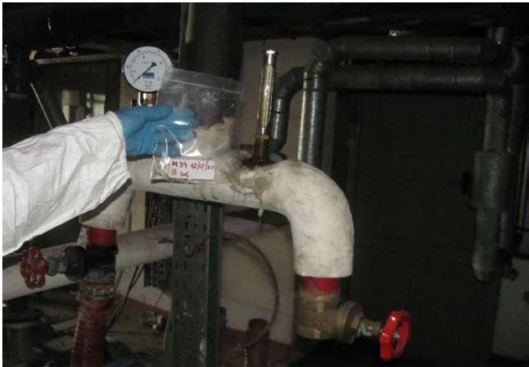
Muestra 2: se obtiene desde zona averiada de material aislante de la cañería.
