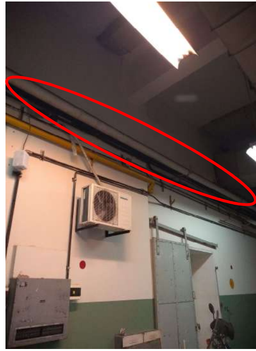
Recorrido cañería con material aislante.
