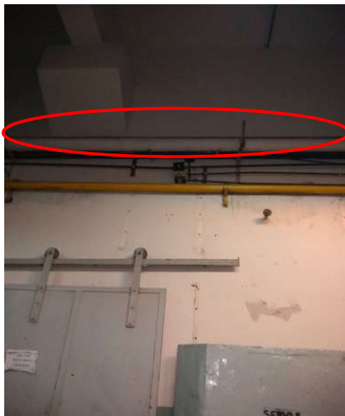
Recorrido cañería con material aislante.
