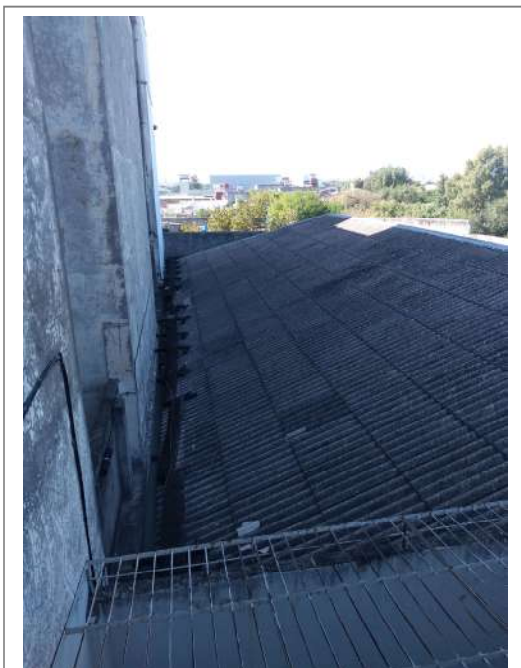
c.1.1) Detalle chapa de fibrocemento en cubierta ala izquierda.
