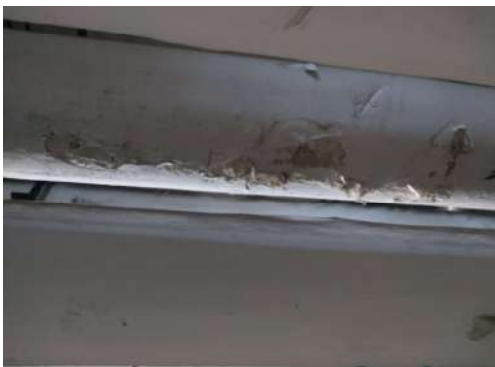
Detalle avería en material aislante.
