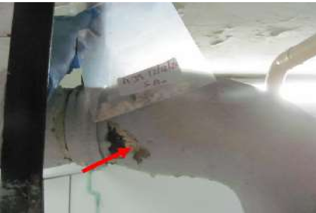
Muestra 3: se obtiene desde zona averiada de material aislante de la cañería.
