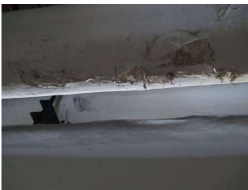
Detalle avería en material aislante.
