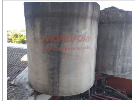
c.1.2) Detalle de tanques de fibrocemento.
