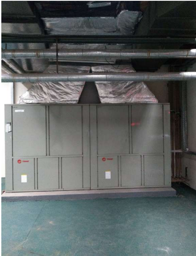
Sistema de aire acondicionado centralizado del sector de calderas.
