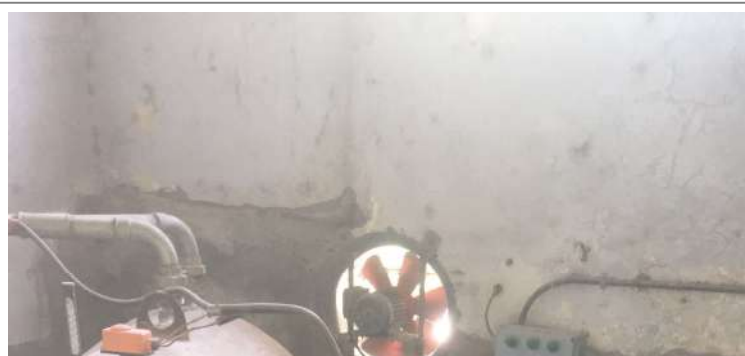
Sistema de extracción de aire localizado detrás de caldera con salida al ambiente exterior.
