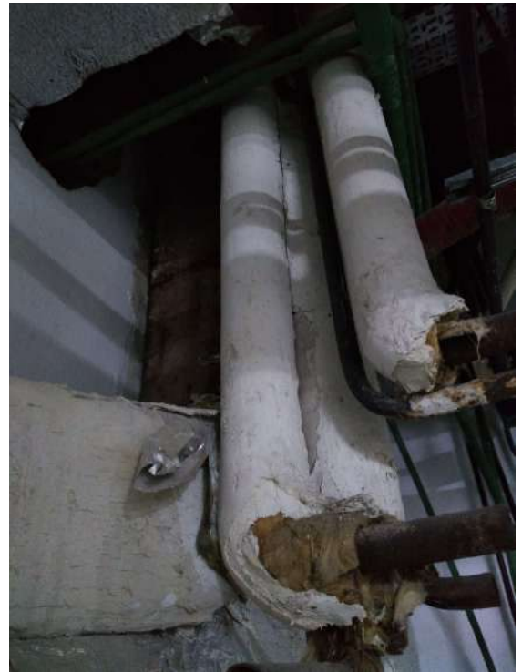
Detalle avería en material aislante.
