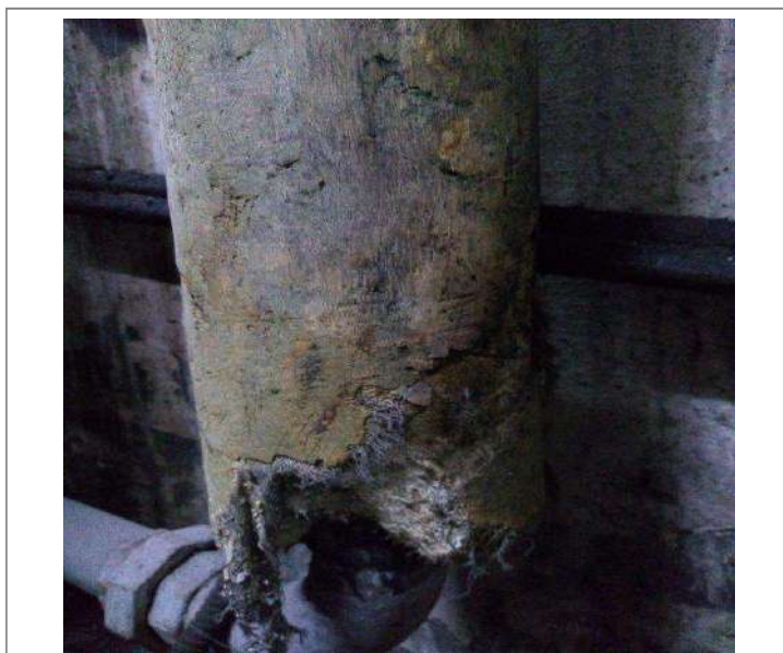
Uso de califugado en cañería: material mezcla (asbesto, yeso y agua) soportado por una envoltura textil que lo afirma a la estructura, en este caso una cañería.
