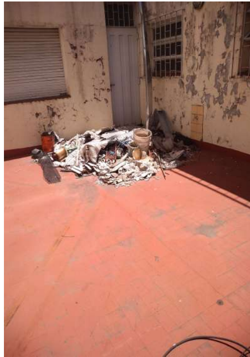
c.1.3) Residuos de fibrocemento en terraza
