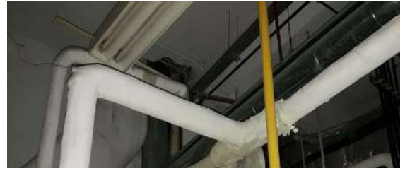
Detalle avería en material aislante.
