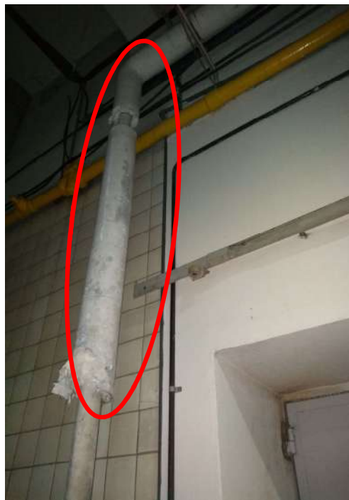
Subida de cañería con material aislante.
