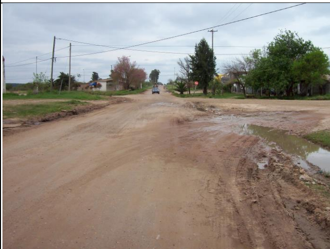
Foto 13 – Intersección Villa Libertad y 28 de Mayo – Inconvenientes luego de la lluvia, rotura de calles
