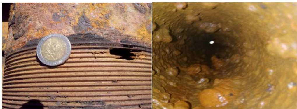
Figura 1: Corrosión exfoliante, izquierda. Nódulos bioincrustados, derecha.
