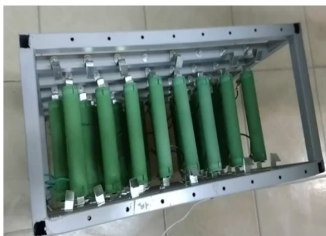
FIGURA 9 Banco de resistencias (dump load).
