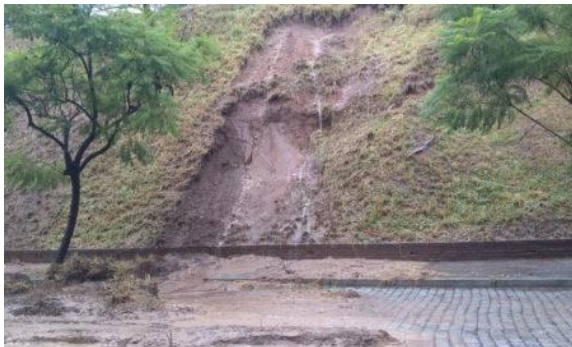
Fig. 13. Landslide due to diluvium.
