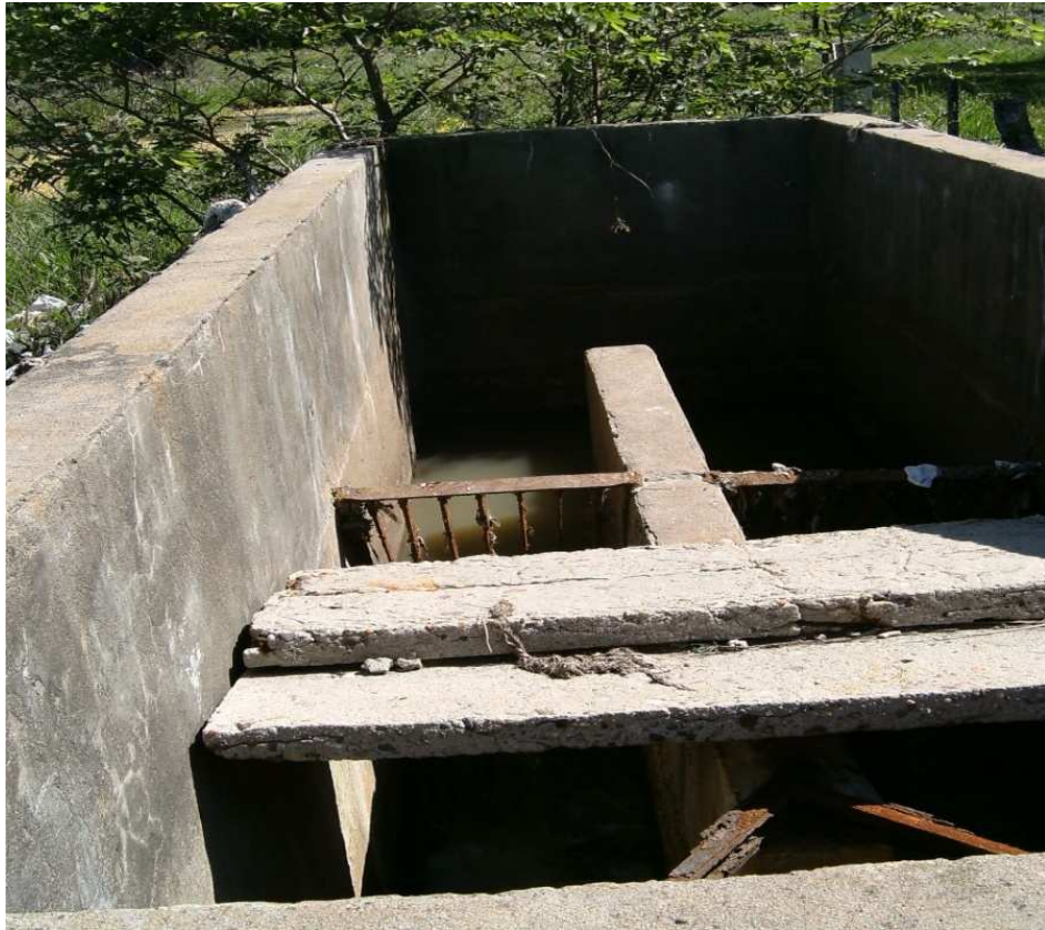
Foto 9: Cámara de rejas actual existente en la cual se observan obstrucciones con basura.
