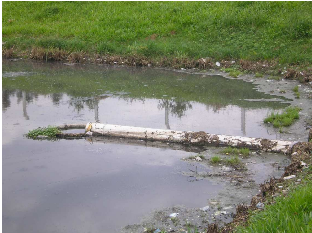
Foto 4: Vista de cañería y cámara de interconexión entre Lagunas Anaeróbica y Facultativa
