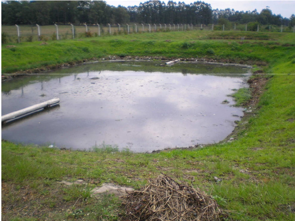
Foto1: Vista General de la Laguna Anaeróbica, se observa la presencia de residuos en superficie.
