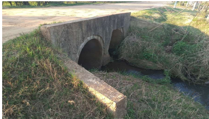
Figura 14: Alcantarilla de 2 caños de H° de 1100 mm, entre calles Scalabrini Ortiz y Canadá.
