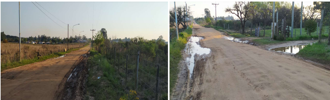
Figura 12 y 13: Estado de calzada: regular. Presenta zonas erosionadas y mal escurrimiento de aguas.
