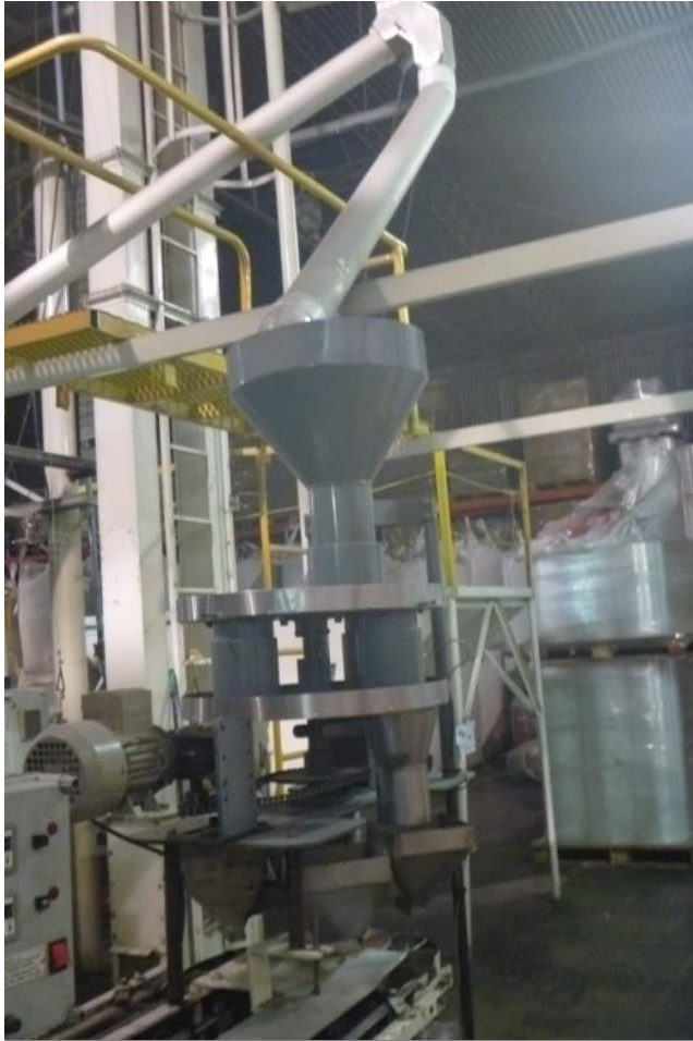
Fotografía 3: Dosificador de línea 10
