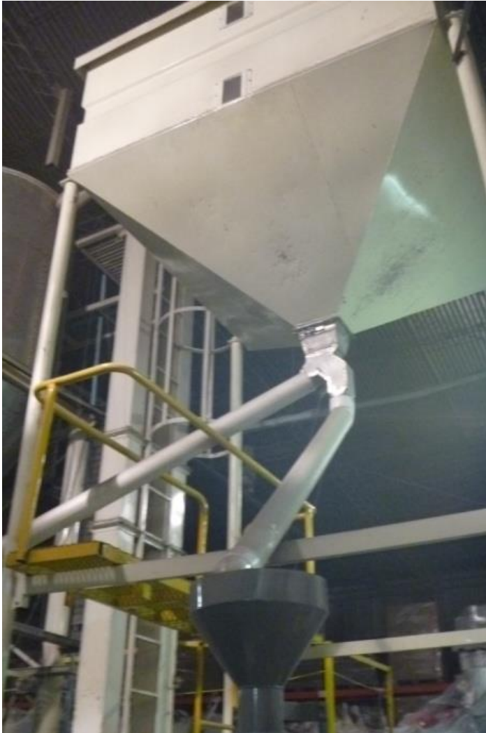
Fotografía 2: Tolva con caños de bajada de arroz hacia el dosificador
