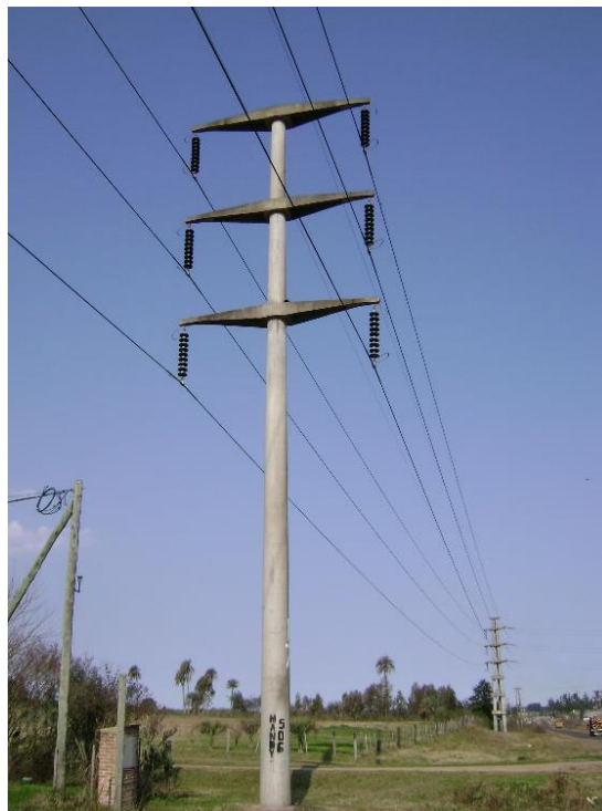
Estructura convencional de crucetas Línea doble terna Masisa Vano: 150 m
