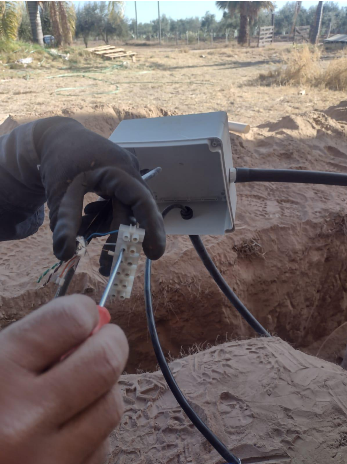
Zona de derivación hacia inversor esclavo y tablero de bomba mediante borneras.
