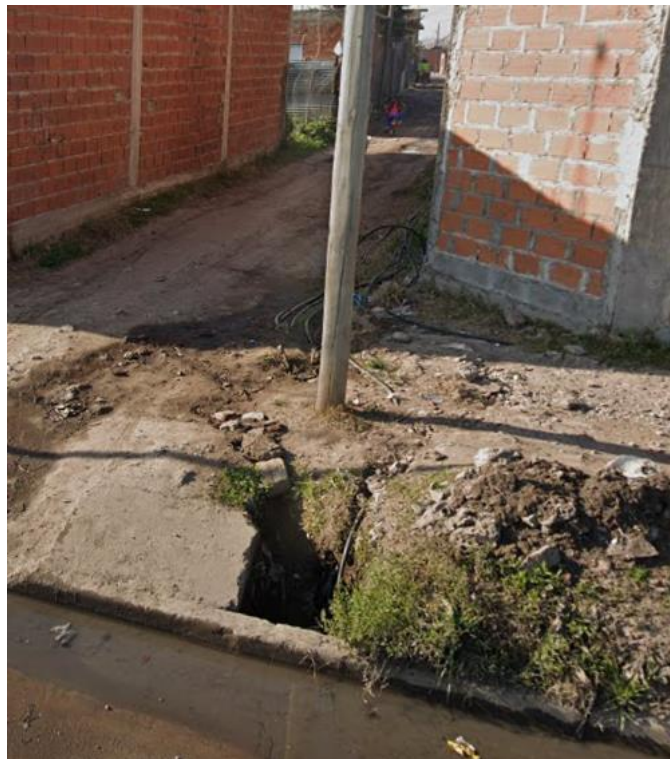
Figura 7: Se observa las instalaciones informales mediante mangueras
