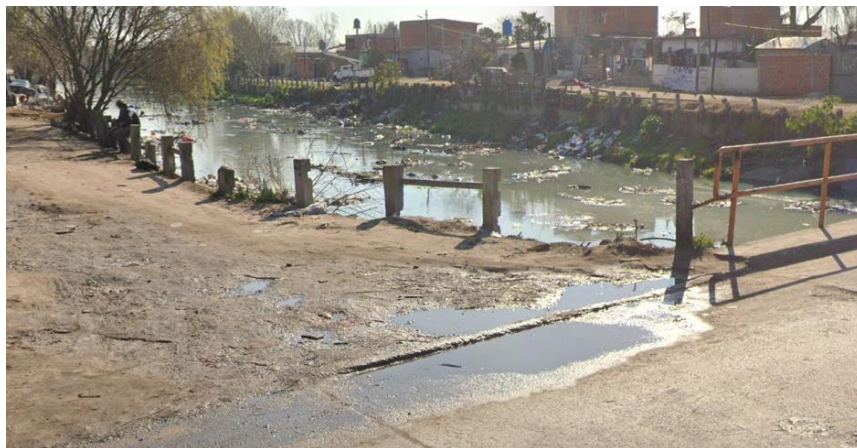
Figura 11: Barandas alrededor del arroyo en mal estado
