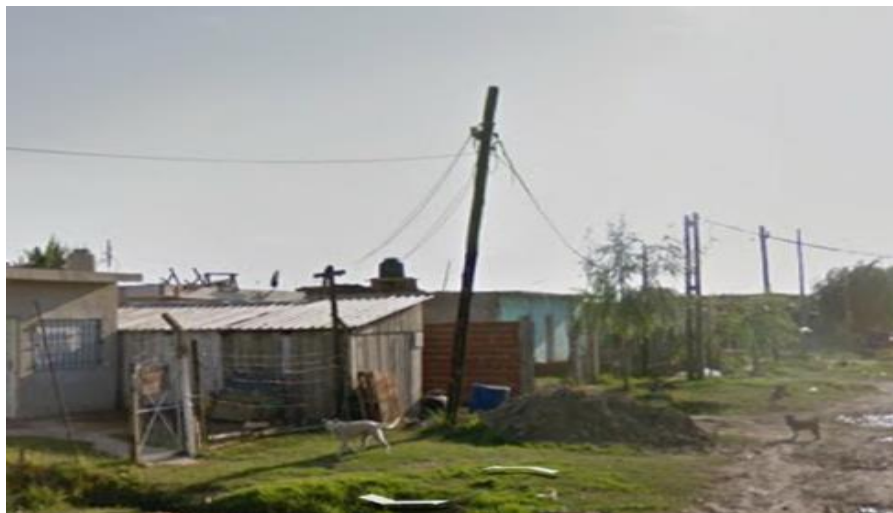
Figura 12: Postes de luz en mal estado falta de luces
