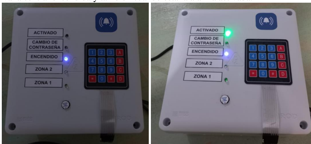
Figura 49: Central encendida y alarma activada.
