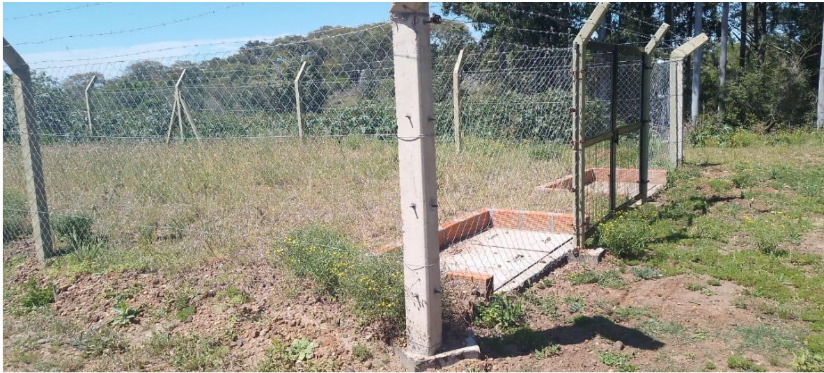
Figura 11- Sistema de Tratamiento de Líquidos Cloacales en Puerto Yerúá
