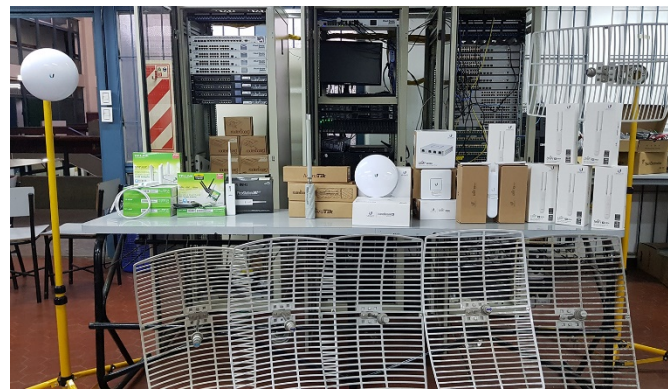
Figura 4. Otro equipamiento del Laboratorio.
