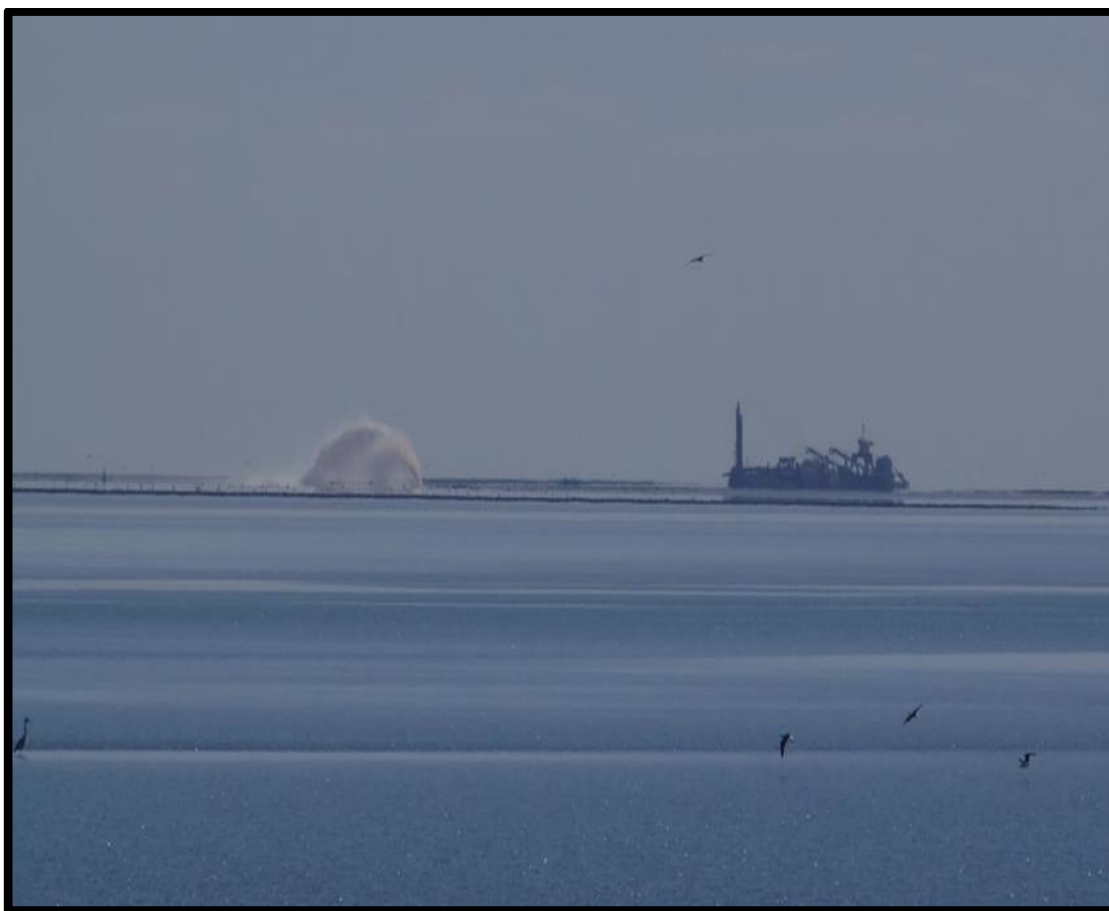
FOTO N° 2: Dragas operando en Canal de Acceso Bahía Blanca. Fuente: Gabriel Alejandro Mujica – agosto 2013
