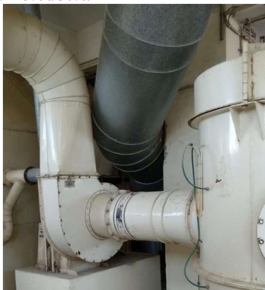
FA1 – SP292005 (descarga del ventilador actual)
