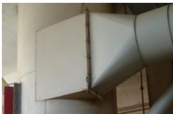
F01C – Se mantendrá la campana original que une el filtro con la tubería
