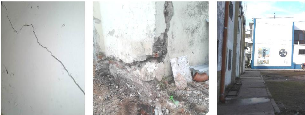
Figura 1. Izq.: Fisuras a 45° en muros. Centro: Grietas en esquinas. Der.: Rotura de veredas.
