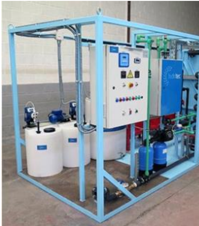
Fig.55: Equipo de dosificación de cloro (TECPA).
